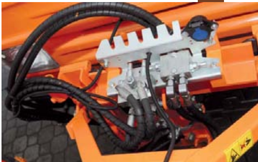
Необходима проверка гидравлической системы
